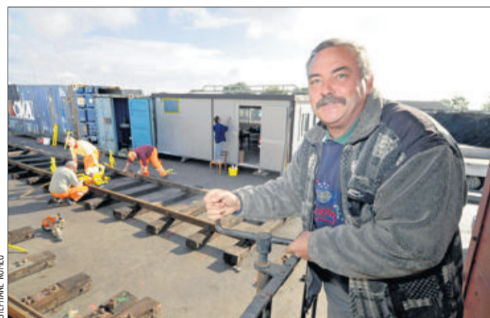
Denis Sippel, président de l'Association Nyon-St-Cergue Rétro, observait hier la pose des rails à la compostière de Givrins.
